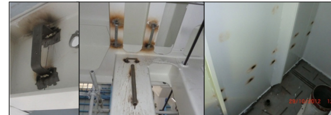
Großflächige Beschichtungsschäden beim Schweißen durch hohen Wärmeeintrag an Haltern und auf der Rückwand
